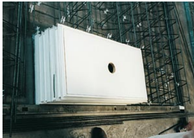
Nach Abschluss der Bewehrungsarbeiten wird unmittelbar vor dem Betoniervorgang das durch die äußere Montageplatte geschützte Leibungsfenster aufgesteckt. Ein zusätzliches Niederhalten ist in der Regel nicht erforderlich
